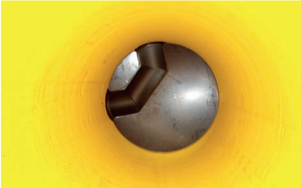
Bøjning i brønd ID800
