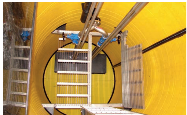
Pumppaamo (näkömä sisältä)
