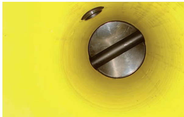
Studzienka rewizyjna kanalizacji sanitarnej DN/ID800
