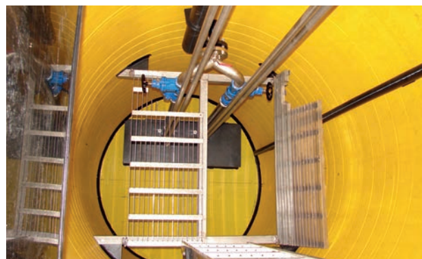
Pumpstation (sett invändigt)
