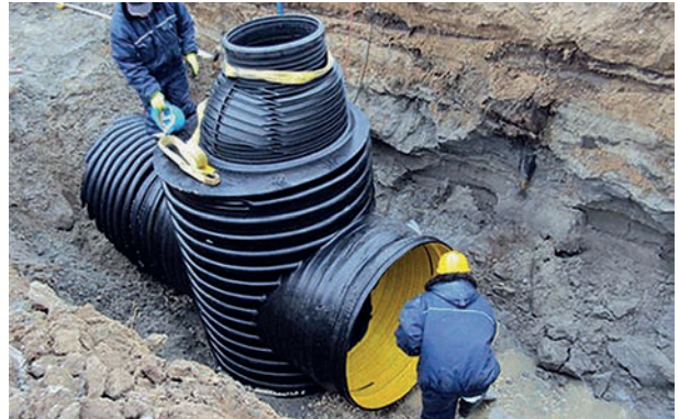
Kontrollbrunn för dagvatten, DN/ID1500
