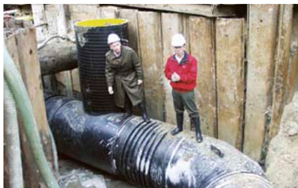
Kanalisatsioonitorustik elektrikeevisühenduse abil ühendatud poogna ja kontrollkaevuga, DN/ID 1200mm
