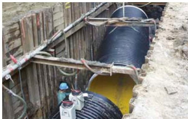
Kanalisatsioonitorustik DN/ID 2000mm
