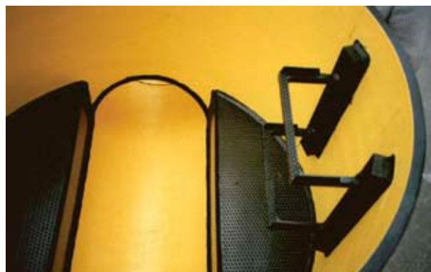
Standardse kontrollkaevu sisu
