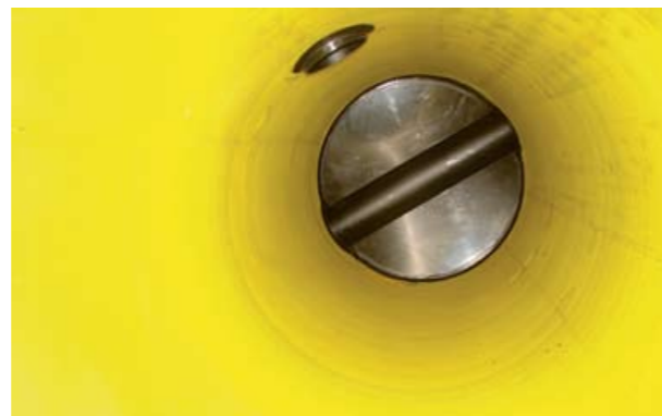
Kanalisatsiooni kontrollkaev DN/ID800
