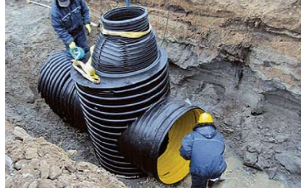
Sademevee kontrollkaev DN/ID1500
